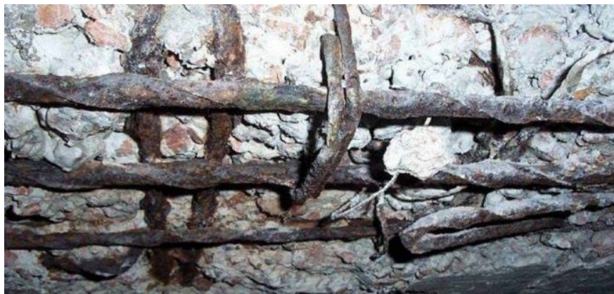
Figura 2.5: Efectos en el sistema hormigón armado
